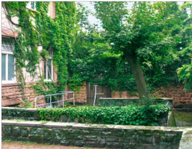
Eine romantische, verwunschene, aber baufällige Ecke auf unserem Campus...
